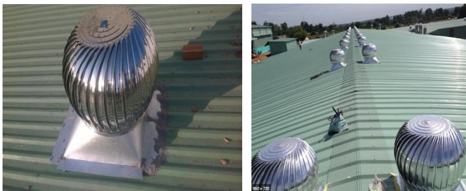
Hình 3.1: Hệ thống quả cầu thông gió
