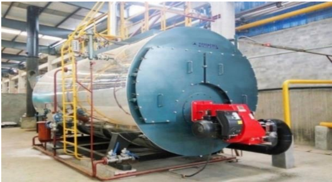
Hình 2.5: Nồi hơi tại Công ty
