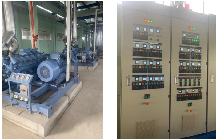
Hình 2.9: Máy IKAGAI điện dự phòng và bảng điều khiển tại Công ty
